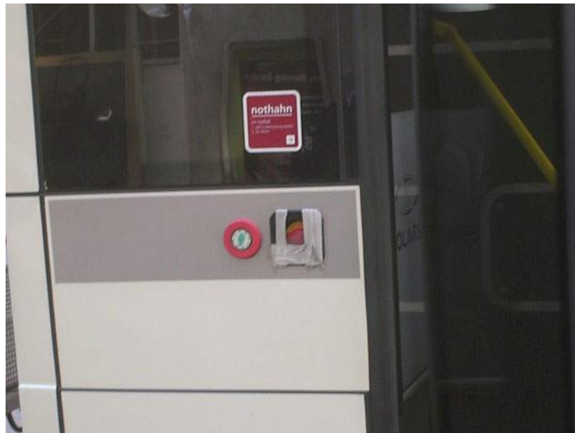
Bild 3: Notdürftig überklebtes Entlüftungsventil anstatt ordentlicher Reparatur.
